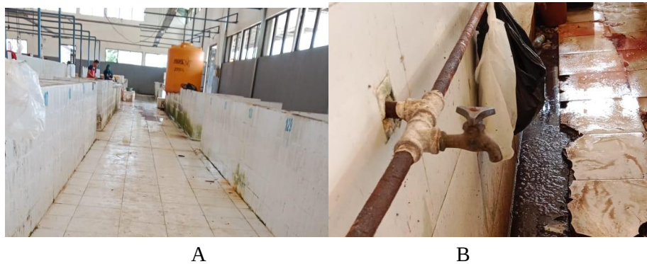
Gambar 7. Penyediaan Air bersih (A. Profil Tank dan B. Kran Air)
