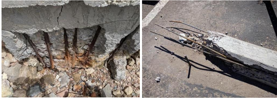
Gambar 2. Detail Penulangan Tidak Memenuhi SNI
