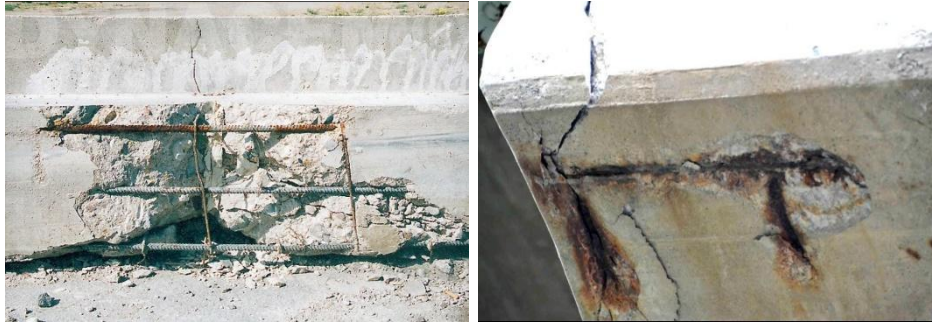
Gambar 1. Kualitas Beton yang Kurang Bagus
