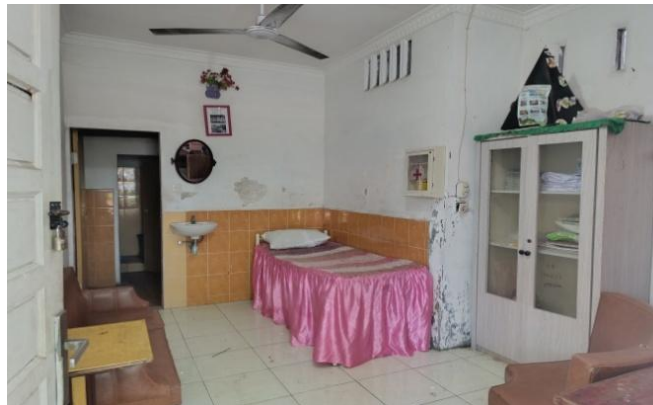
Gambar 3. Penataan UKS yang Terbengkalai
